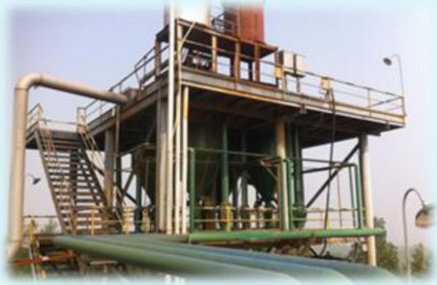
洛宁紫金废水处理系统
