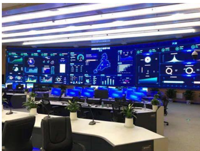
济南智慧泉城运营管理中心一体化
