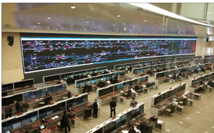
铁路总公司山西集团公司指挥调度系统方案（国内铁路系统首个采用小间距LED显示产品的信息调度指挥中心）
