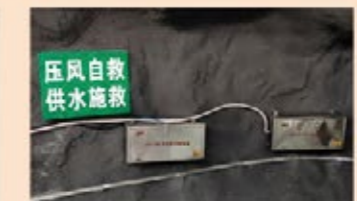
压风自救、供水施救装置
