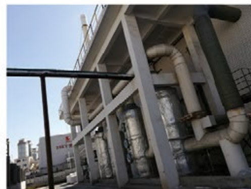
氮氧化物吸收塔
