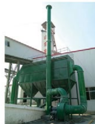
袋式高效除尘设施
