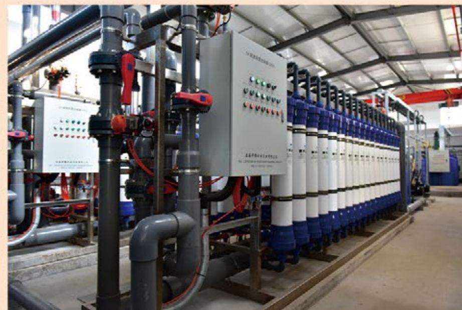
焦家金矿“井下水产品水处理系统”——国内外首例金矿井下水超滤反渗透双膜梯级处理及其自动控制技术与装备
