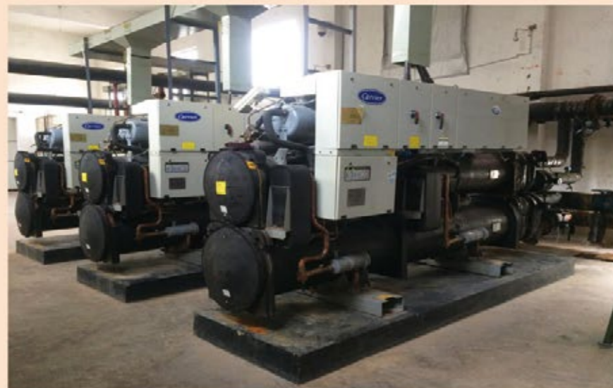
归来庄矿业公司水源热泵设备
