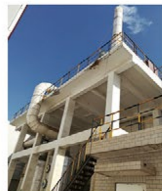
酸性气体吸收塔
