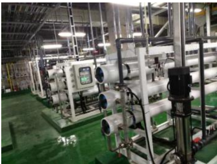
工业废水零排放二期工程 (金桥厂)
