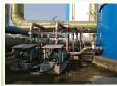
▲改造后的沼气输送项目
