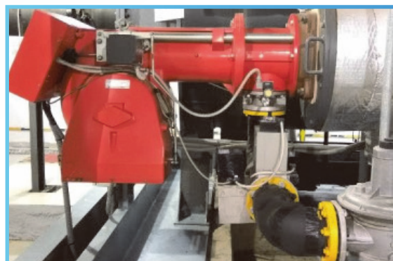
▲ 我們正在對上海吳中歐麗洛雅商場空調進行低氮改造，減少氮氧化物的排放。
