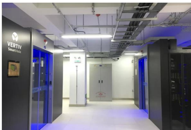
新建机房展示
