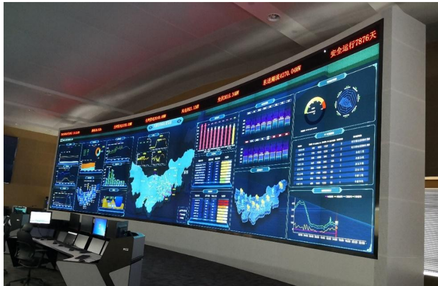
图 6：电力调度指挥中心现场图
