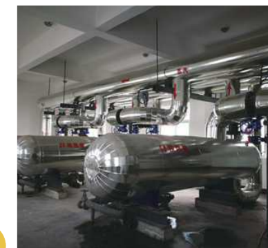
集中供暖管道
