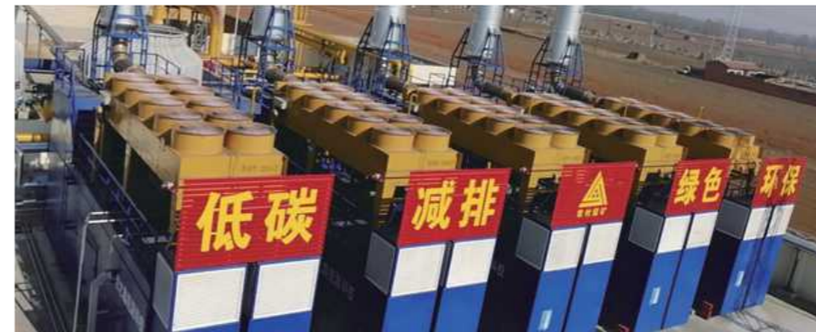
王村风井瓦斯泵站发电项目
