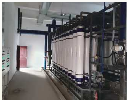
五阳煤矿矿井水深度处理装置
