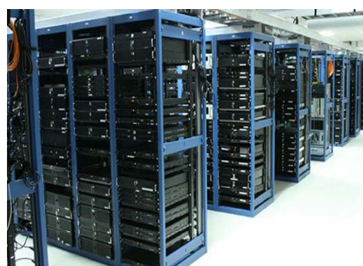
上海呼兰数据中心
