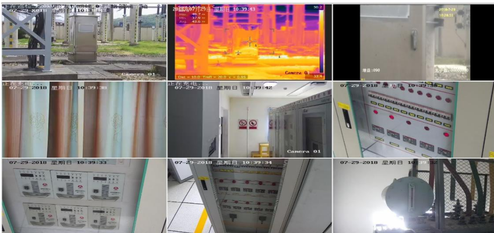
图：智能巡检系统全站监控
