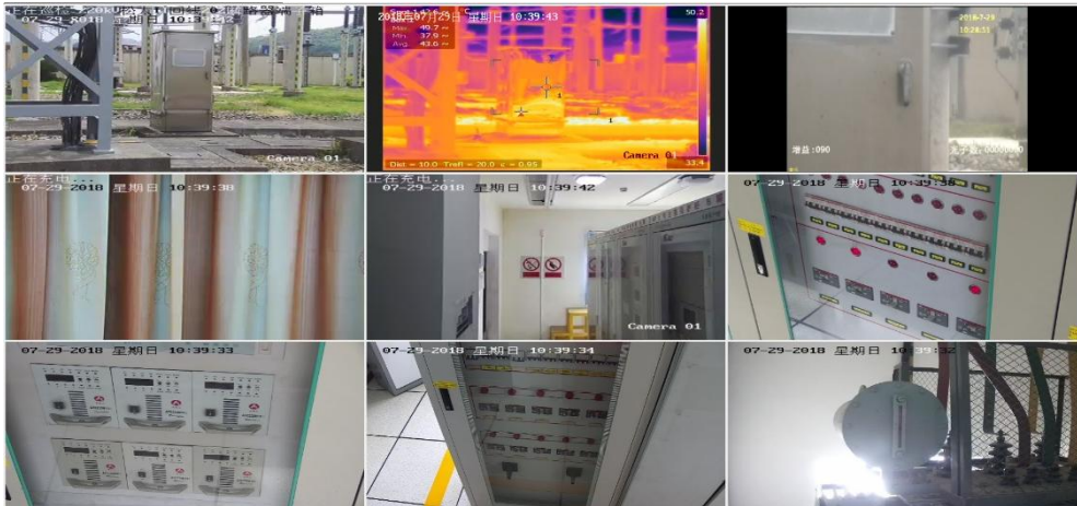
图：智能巡检系统全站监控
