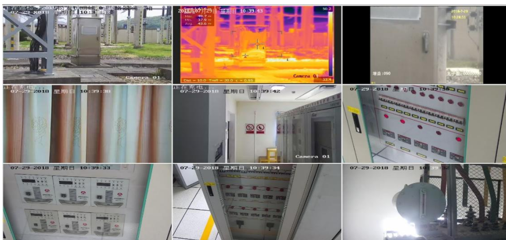
图：智能巡检系统全站监控
