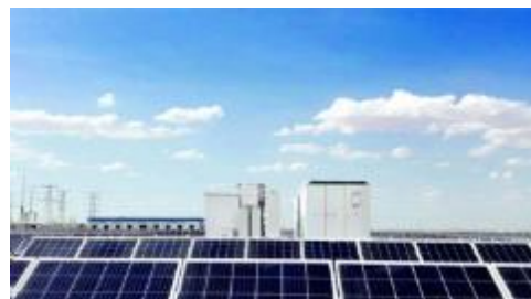
新能源电源管控设备
