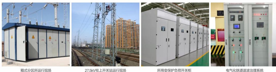
箱式分区所运行现场
