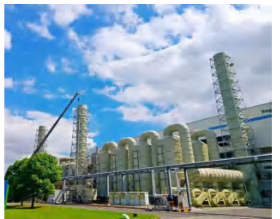
（扬州协鑫光伏项目）
