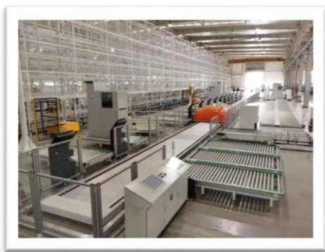
中压柜生产线
