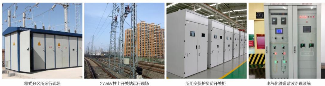
箱式分区所运行现场
