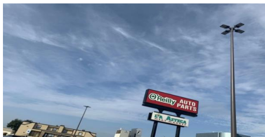
美国 O'Reilly 汽车停车场高杆灯项目
