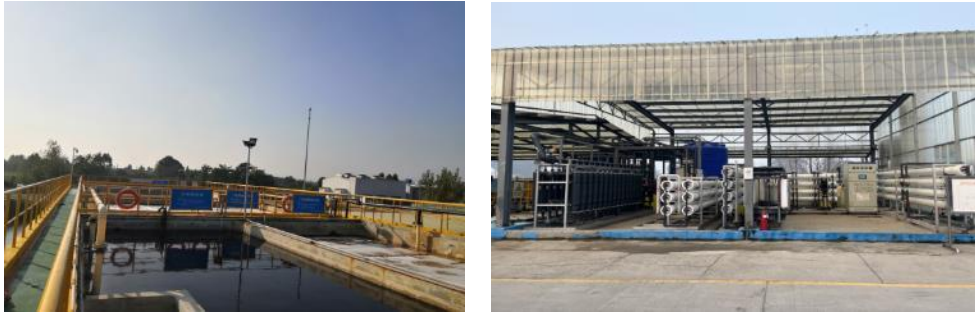
▲工业废水、生活污水集中处理
