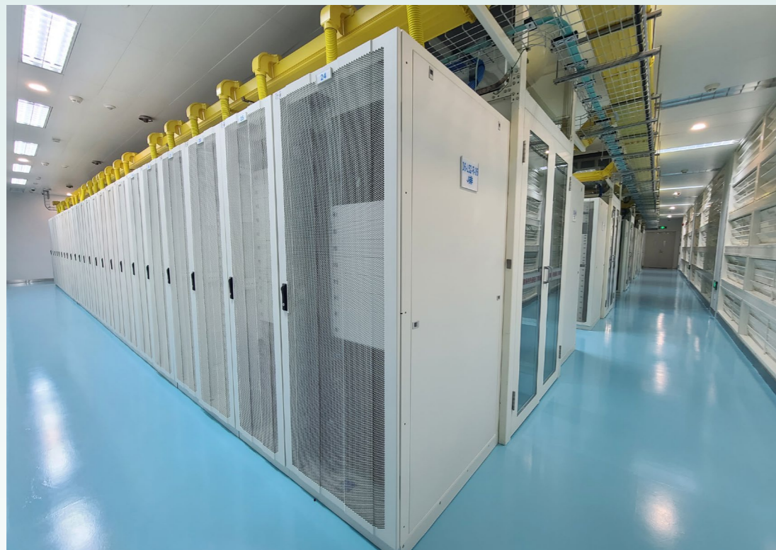
金桥数据中心采用弥漫式气流组织技术提高制冷效率
