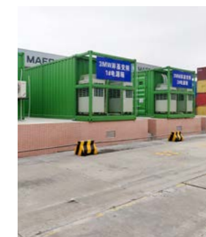
广州港岸电配套建设
