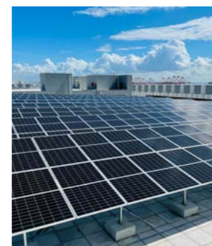
光伏组件完成安装
