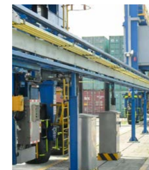
集装箱龙门起重机采用电力驱动
