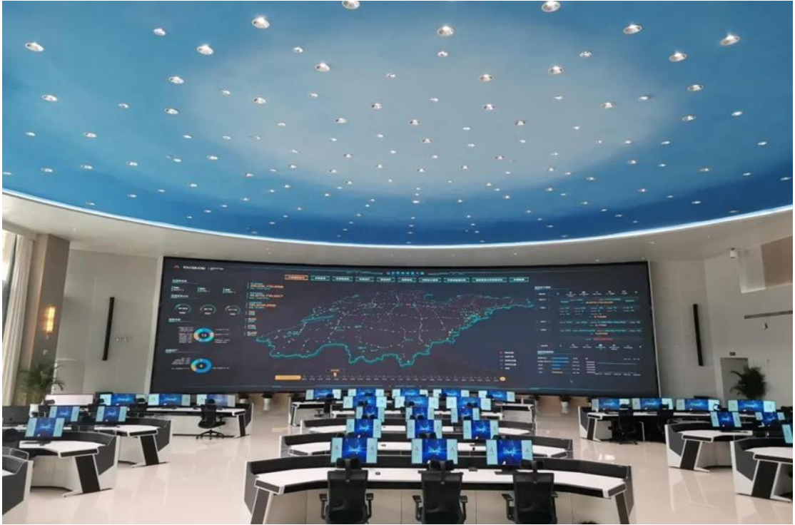
山东省某高速智慧管理中心
