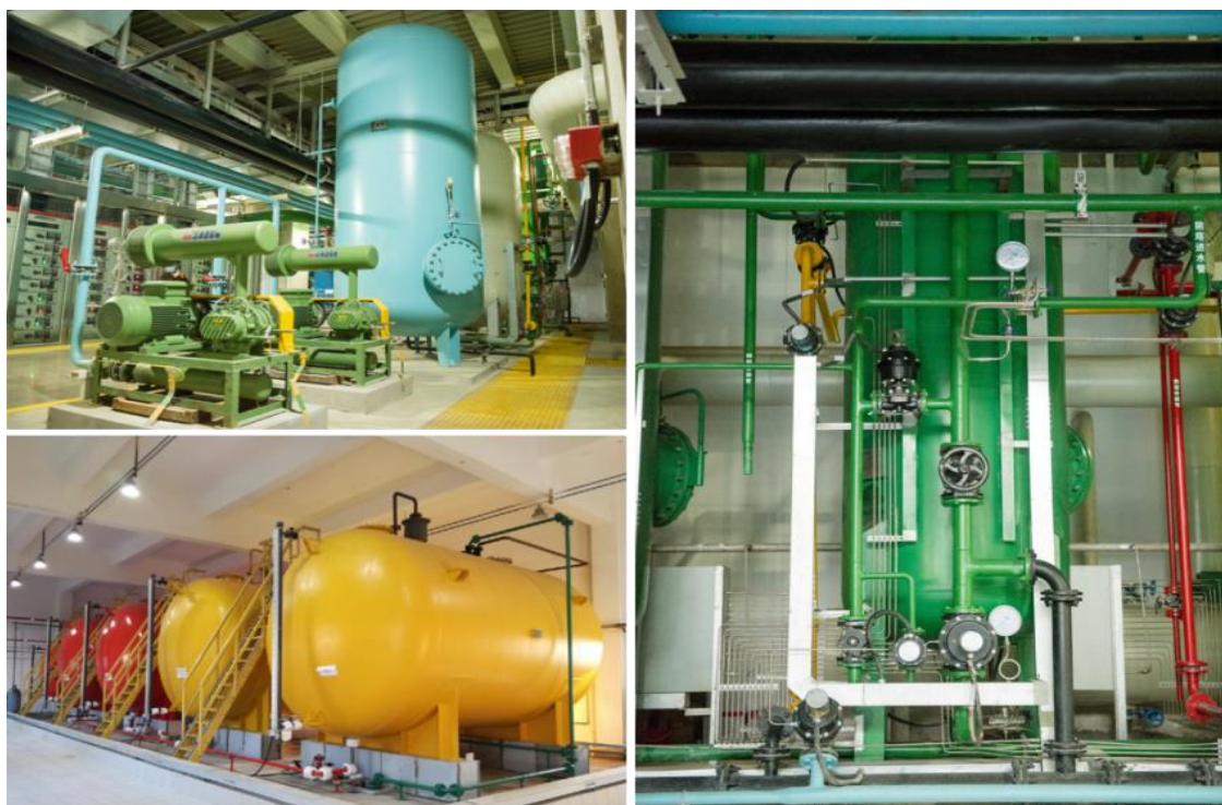
凝结水精处理设备实物图
