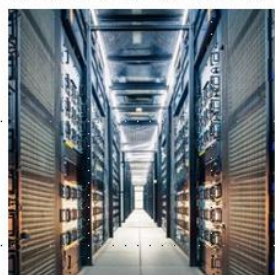
ICT/数据中心
