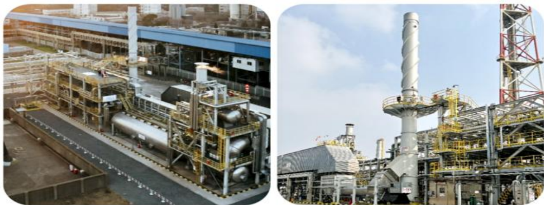
亚德公司承建的中央废气处理及能量回收项目
