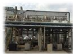
活性炭和碱液废气吸收系统
