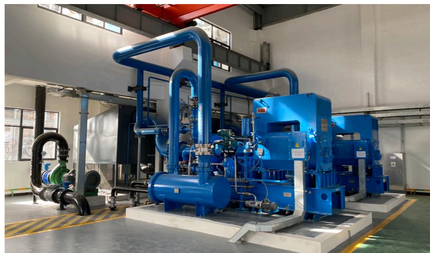
常州公司压缩空气项目建成投产
