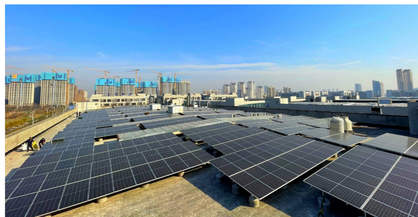
安徽风电淮南高新产业园区屋顶分布式光伏项目
