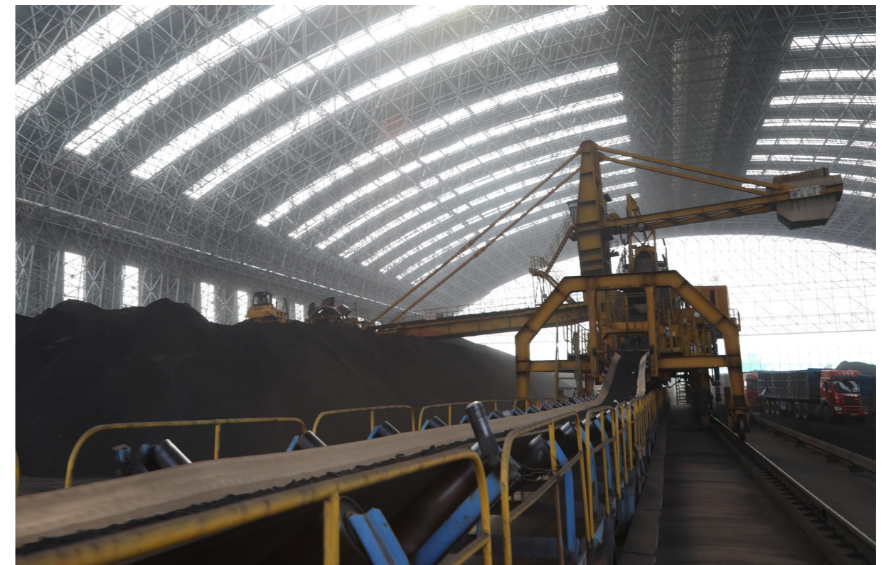
大同电厂煤场
