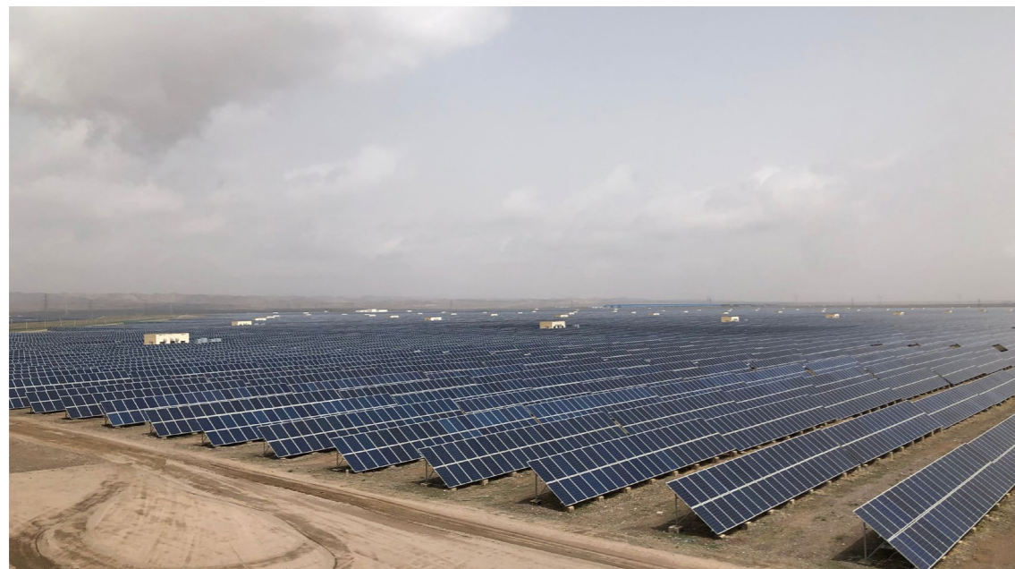
杭州分行支持的甘肃地区集中式光伏电站项目
