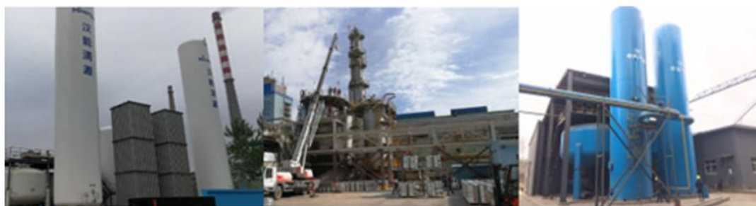
北京汉能清源 3200-93 变压吸附制氧装置
