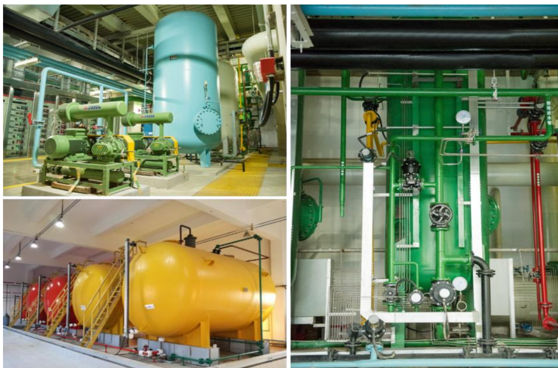
凝结水精处理设备实物图
