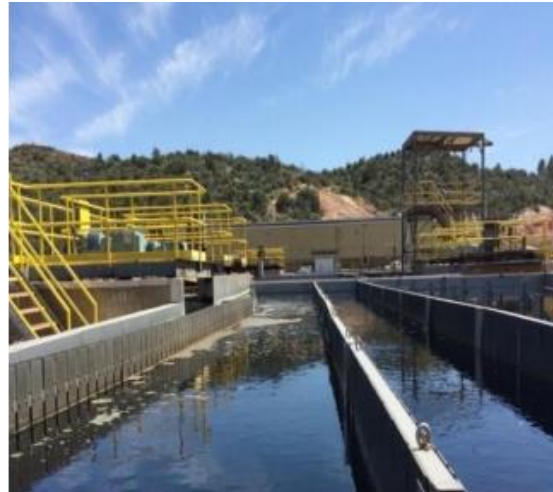
铜萃取槽实景图
