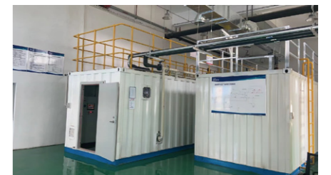
图注：自建污水处理站
