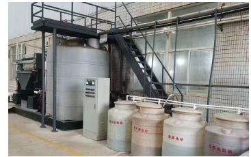
废水预处理设施
