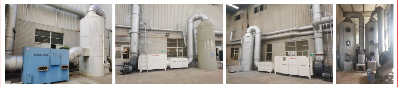
废气处理设施
