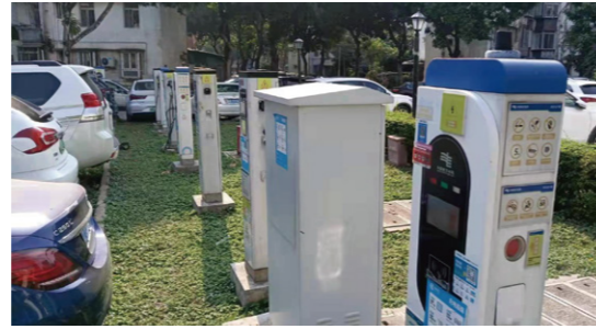
新能源汽车充电桩 ▶
