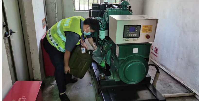
广佛高速泌冲站青年先锋岗为应急发电机添加油料，确保第一时间投入抢险救灾
