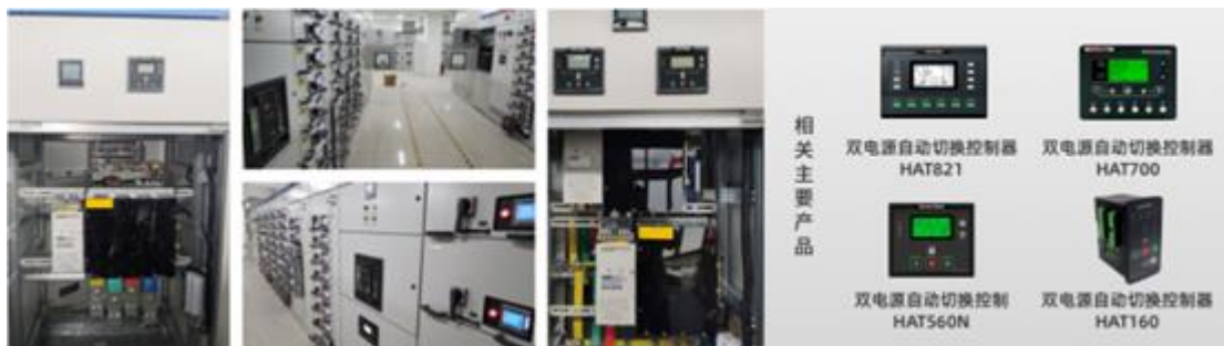
(8) 数据中心应急备用电源
