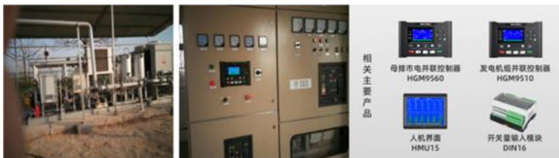
(10) 新能源光伏储能柴发混合供电
