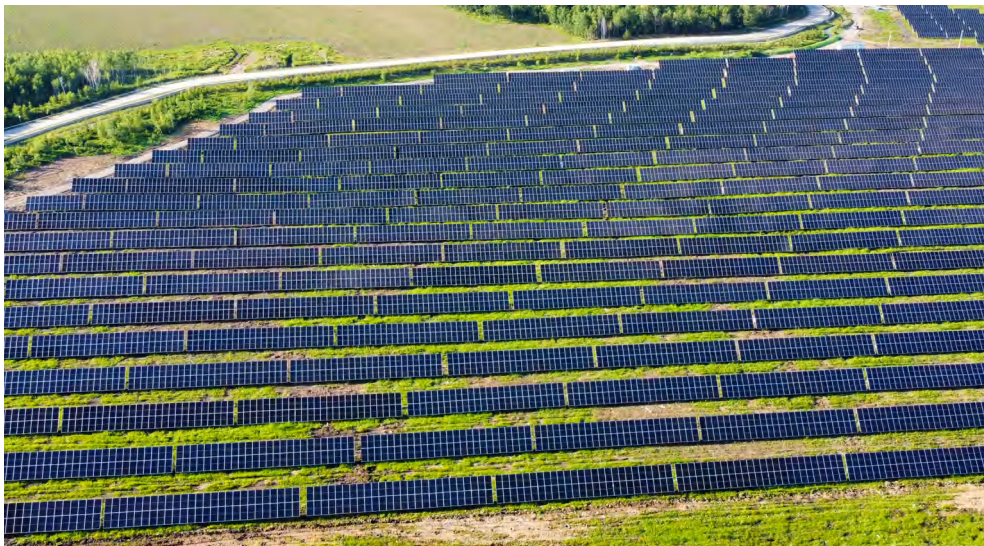
多宝山铜业地面光伏项目
