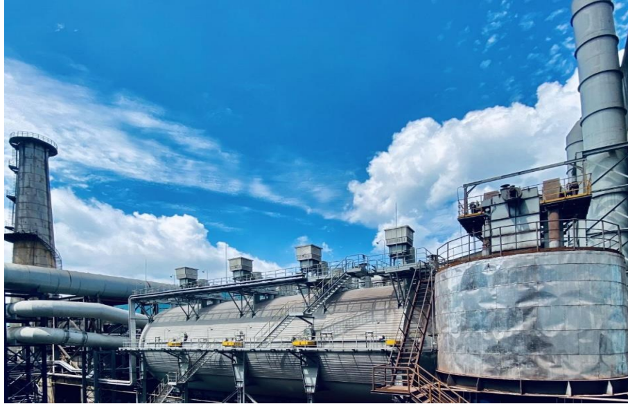
图注：一炼钢完成了两台转炉的干法除尘器改造，改造后每年可节水 1,138 吨、节电 550 万度，并减少 7 万吨污泥排放
