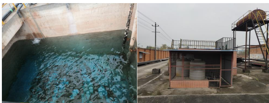
▲工业废水、生活污水集中处理
