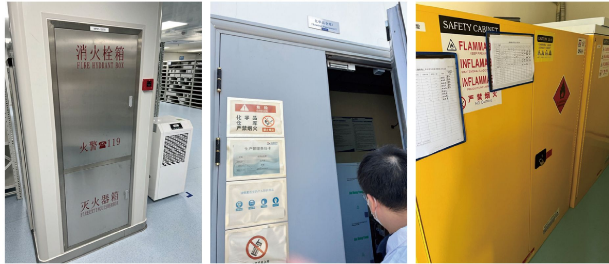
针对安全生产风险对危险品仓库安全情况进行取证
