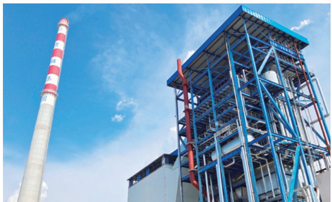
贵糖集团制浆厂碱回收锅炉外景
