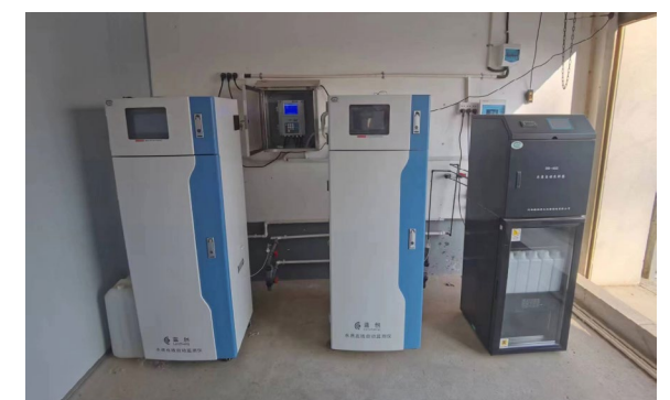
山西运城污水处理在线监测系统
