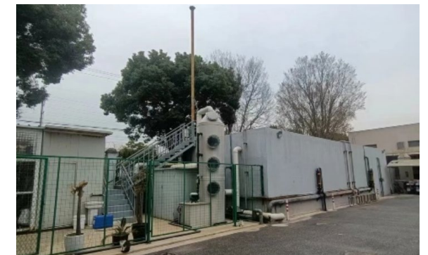
上海永慈污水处理废气处理装置
