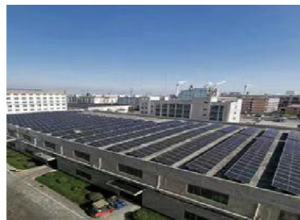
▲ 绍兴德美新材料有限公司光伏发电装置
