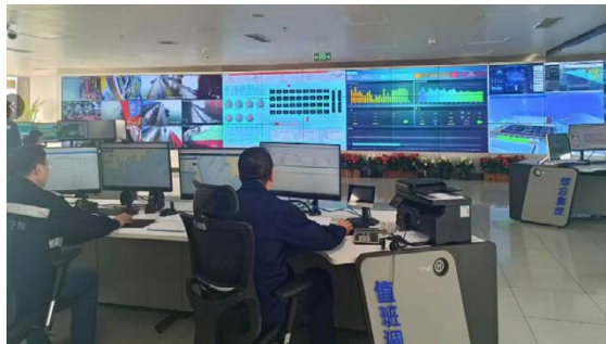
图：秦港股份六公司集中控制室
