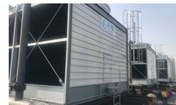
天津厂区节能水塔
