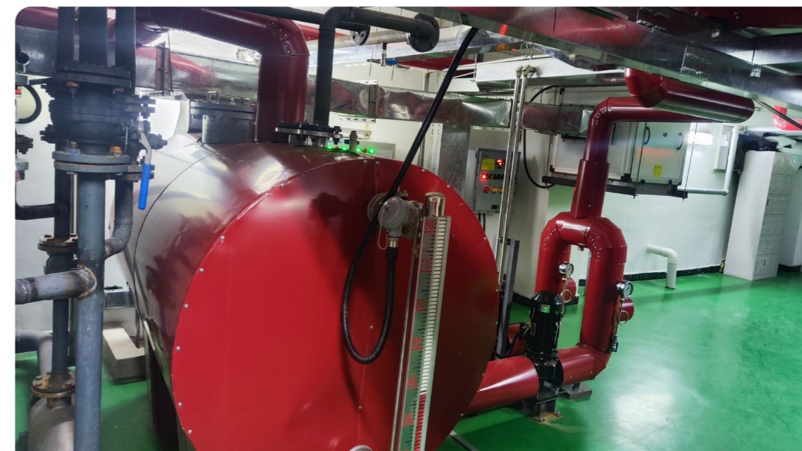
敦化厂区冷凝水回收设备
