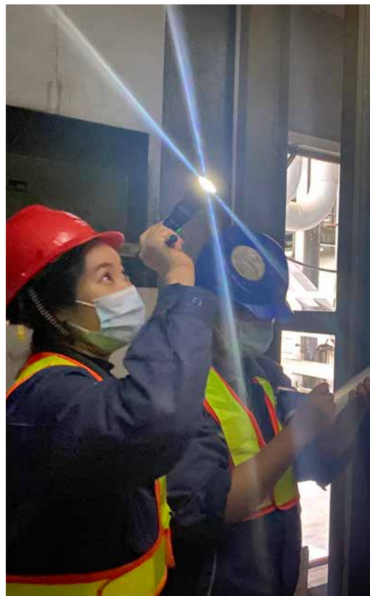
做好设备检修，保障电力可靠供应
