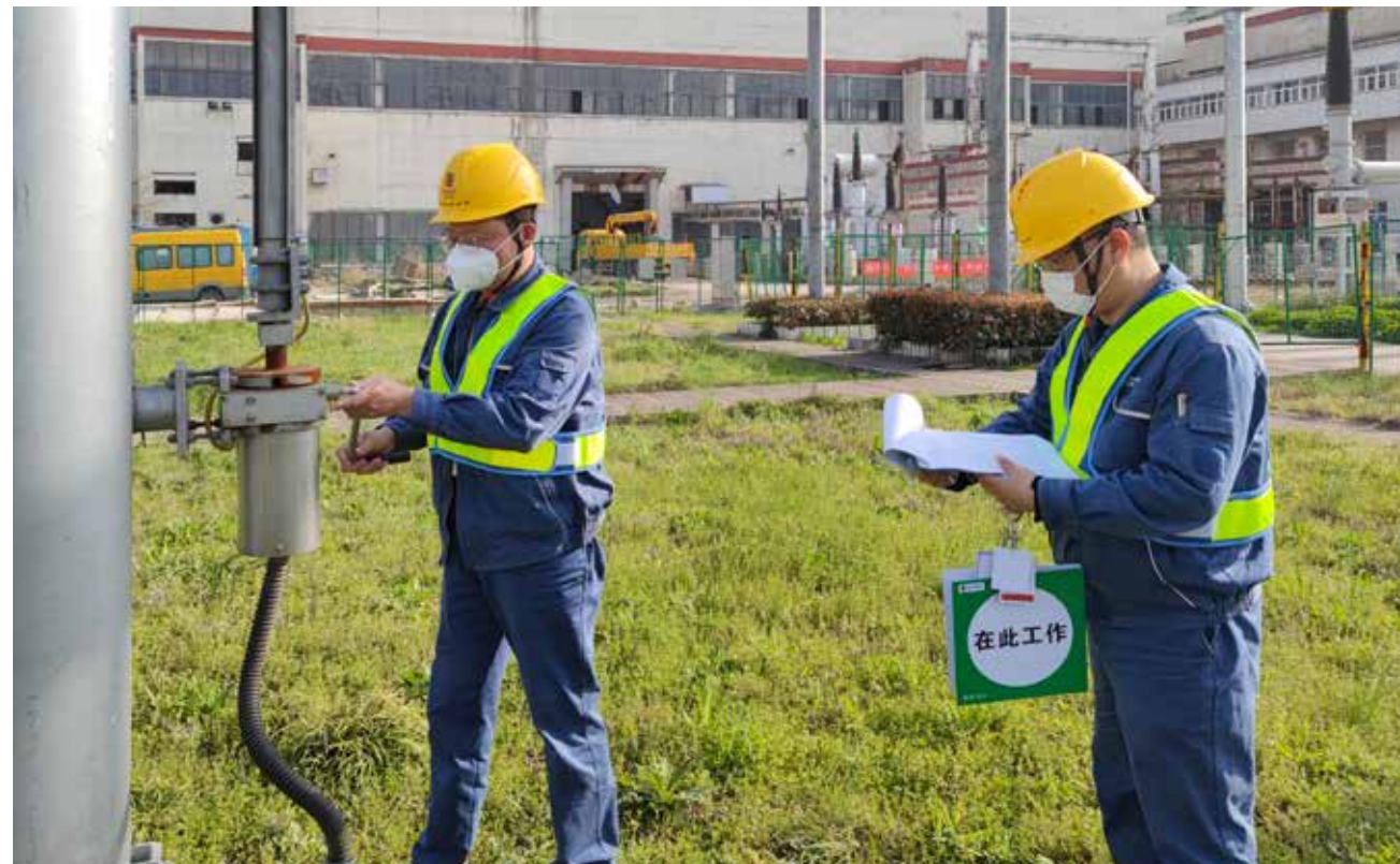
高温天气下，规范操作 220 千伏升压站设备，确保安全生产和能源保供
