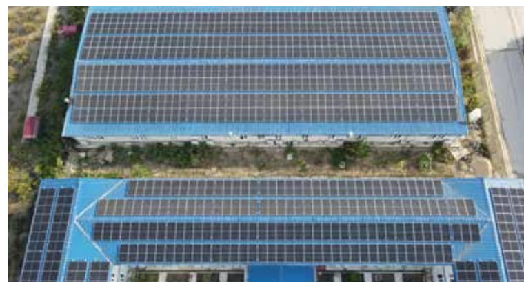
土耳其胡努特鲁风光混合电站项目首批屋顶光伏组件顺利并网，充分利用闲置土地和已构筑屋顶，是土耳其首批批准的煤电 + 新能源“多能源混合型发电站”。
