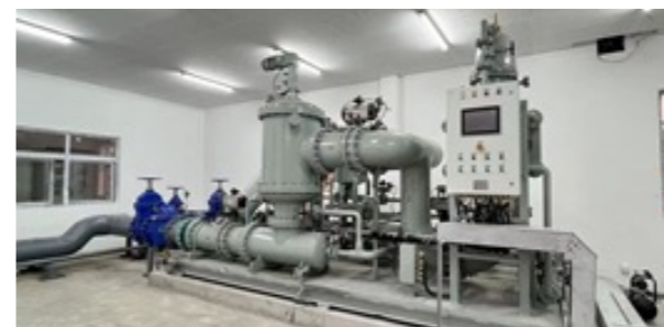
▲ 南沙四期工程压载水处理系统——华南地区首座固定式岸基清洁压载水接收装置，可以应对清洁压载水上岸的各种工况
