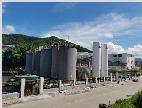
凡口矿选矿废水厂前深度净化处理回用系统
