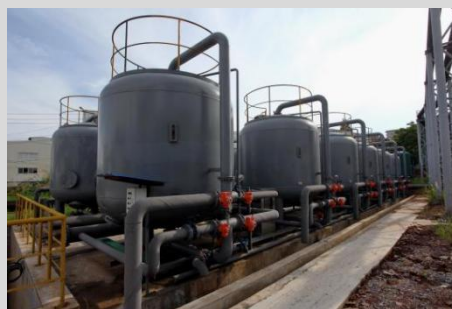
凡口矿井下水澄清处理系统加药罐
