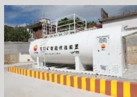
凡口矿智能供油系统地面撬装装置
