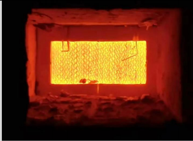
应用了多孔介质燃烧技术的精炼炉燃烧系统
