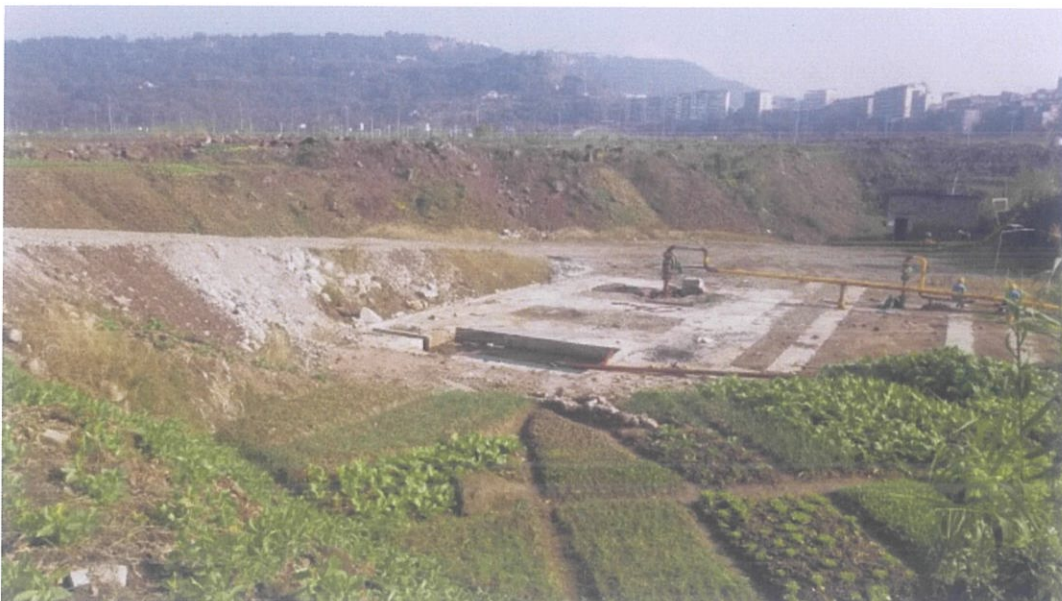
图：卤水管道输送实景图
